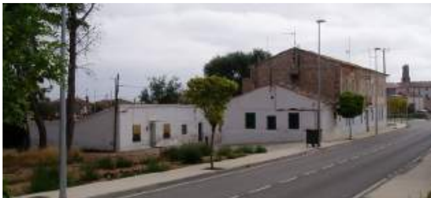
Cuartel Viejo de la Guardia Civil (Cª. de Cariñena). Actualmente destinado a viviendas (en mal estado).
